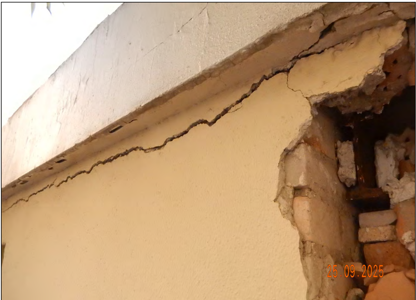
Foto n.5 corpo A -vista distacco solaio /copertura con degrado strutturale
