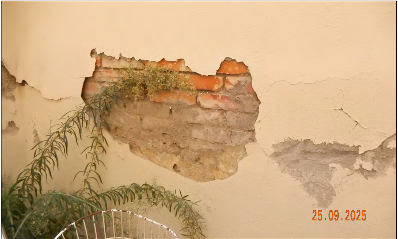
Foto n.4 corpo A -vista paramento esterno degradato
