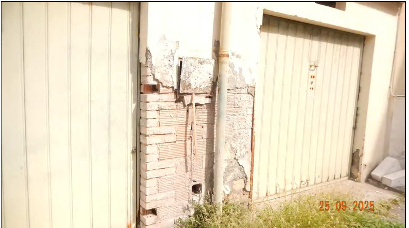
Foto n.5 corpo B -vista degrado delle strutture
