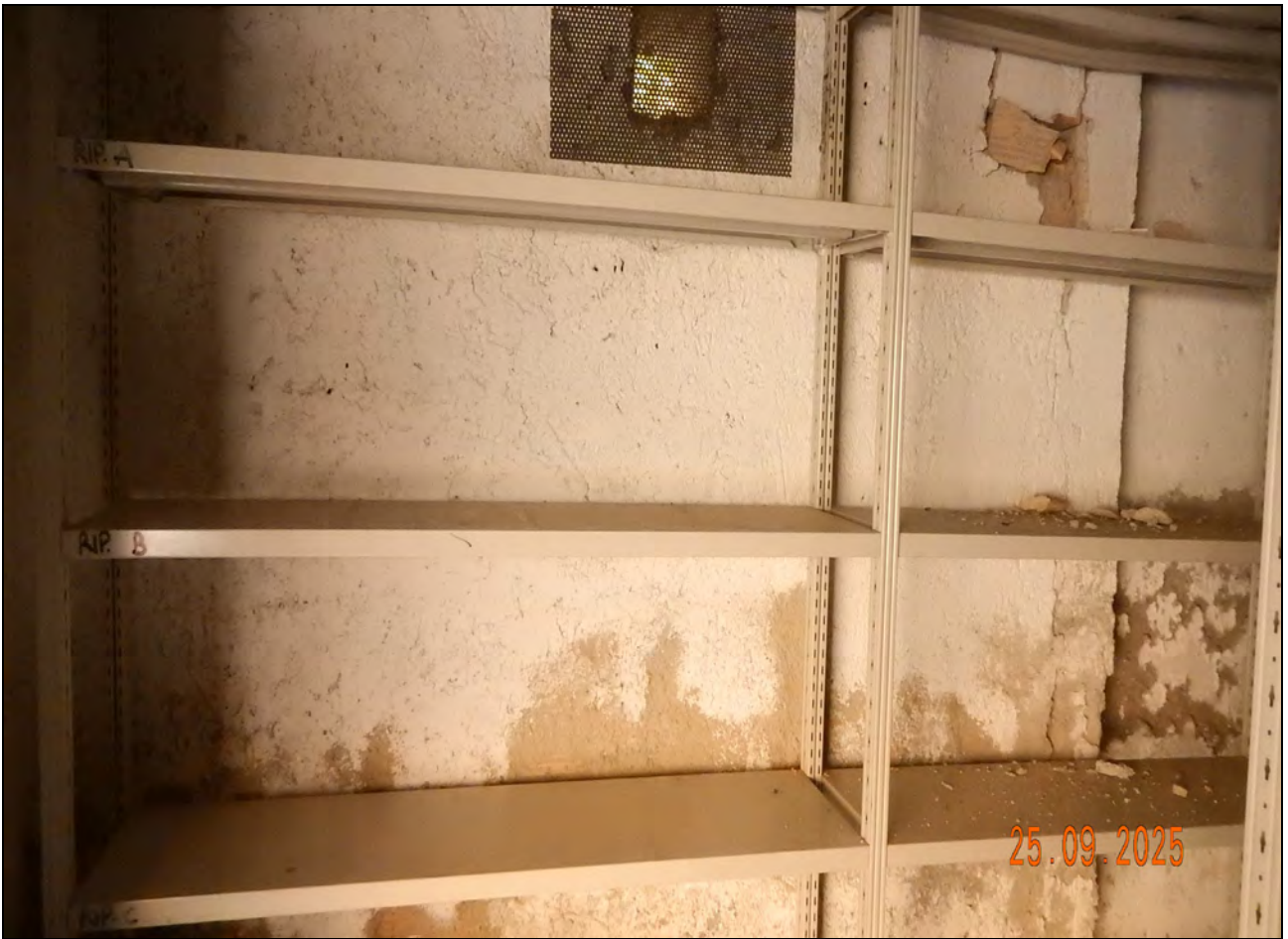
Foto interne corpo A parete posteriore con evidenti segni di umidità e dissesto
