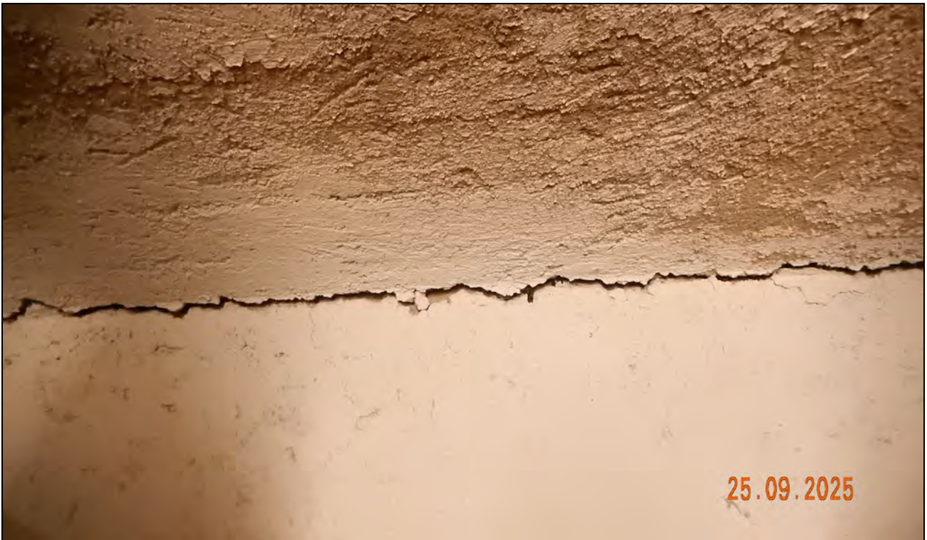
Foto interne corpo A distacco struttura portane verticale con solaio
